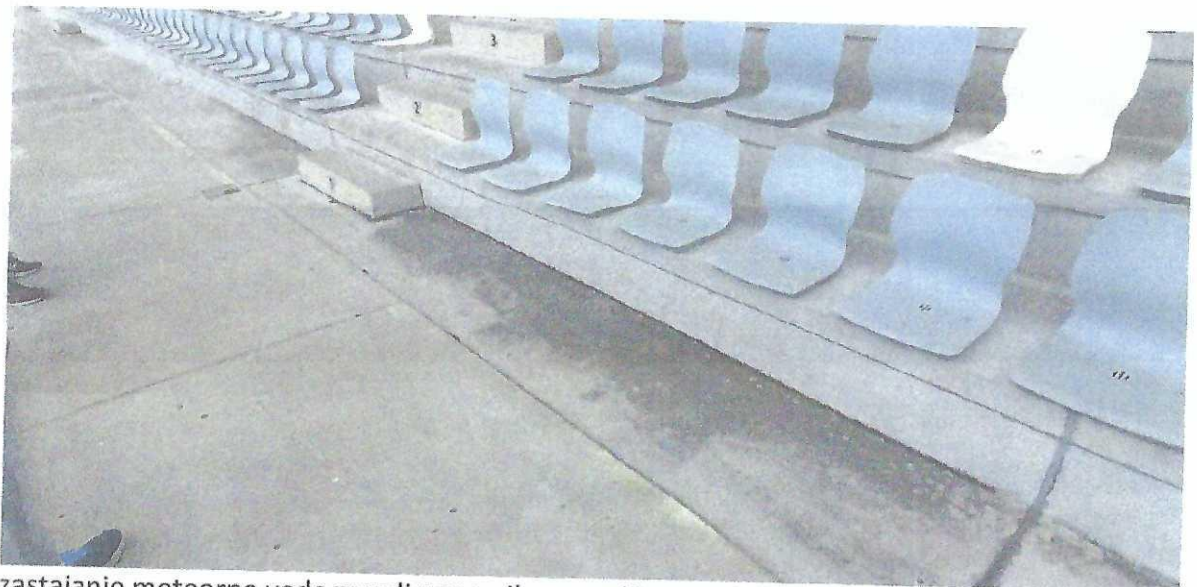
zastajanje meteorne vode zaradi nepravilnega naklona na lokaciji lokalov
