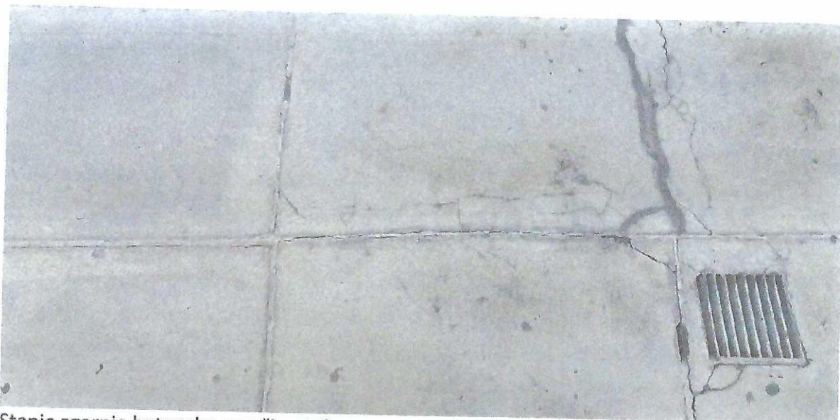
Stanje zgornje betonske površine tribune
