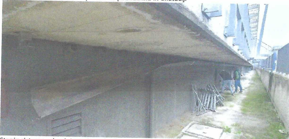
Stanje sistema odvodnjavanja pod tribuno
