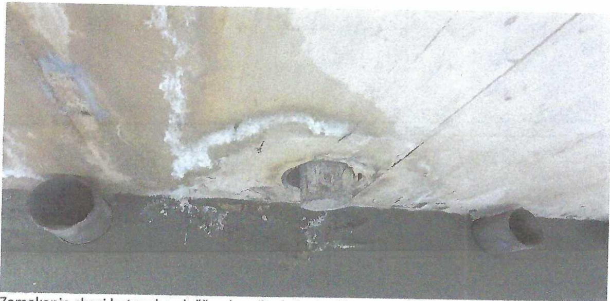
Zamakanje skozi betonsko ploščo ob požiralniku in dilataciji
